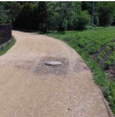
Modernizacja odcinka drogi wewnętrznej w stronę Skawy w Graboszycach, na dł. ok. 115 mb, masą bitumiczną. Wartość zadania 28.413,00 zł.
