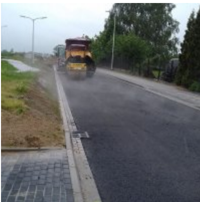
Budowa publicznej drogi gminnej na działce nr 81/20 obr. 0004 w Zatorze, o dł. ok. 85 mb oraz przebudowy skrzyżowania ul. Słowackiego z ul. Mickiewicza -149.000,00 zł.
