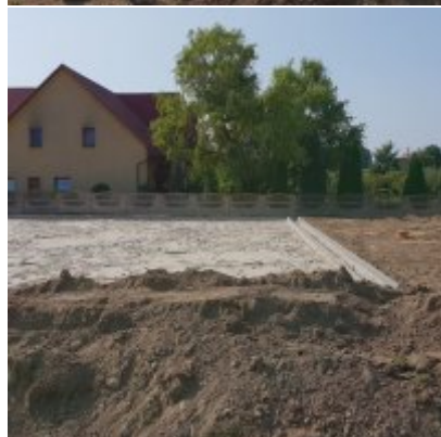
Budowa boiska sportowego o nawierzchni z trawy naturalnej przy ZSO w Zatorze
